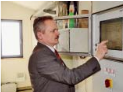
BBL-Geschäftsführer Robert Lumpi an der Schaltzentrale des Blockheizkraftwerks.
